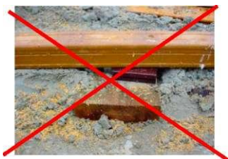
Nosníky nekotvíme do betonu
